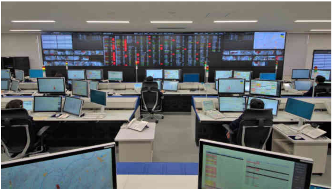
埼玉西部地域消防指令センター 高機能消防指令システム
